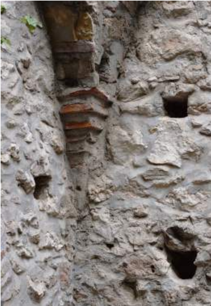
Εικόνα 67: Κιλίβαντας με οριζόντιες πλίνθους στην εσωτερική γωνία της Εστίας της Μ. Βροντοχίου, 2022.
