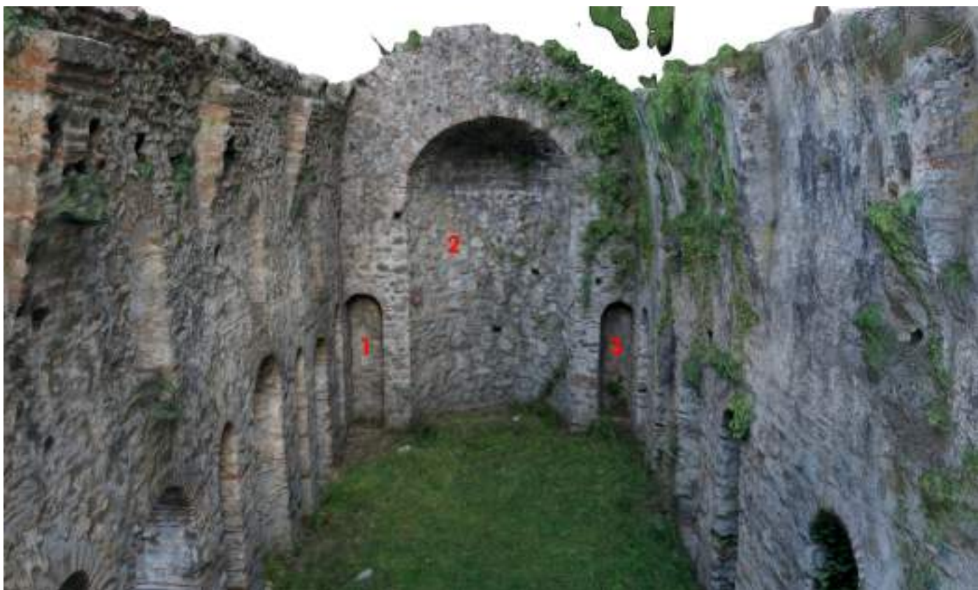
Ανατολικός τοίχος - περιοχές διασωθέντος τοιχογραφικού διακόσμου
