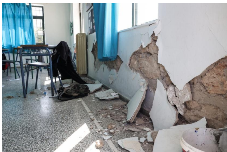
Εικόνα 6 Ζημιές στα σχολικά κτίρια (Πηγή: https://www.tanea.gr/ )
