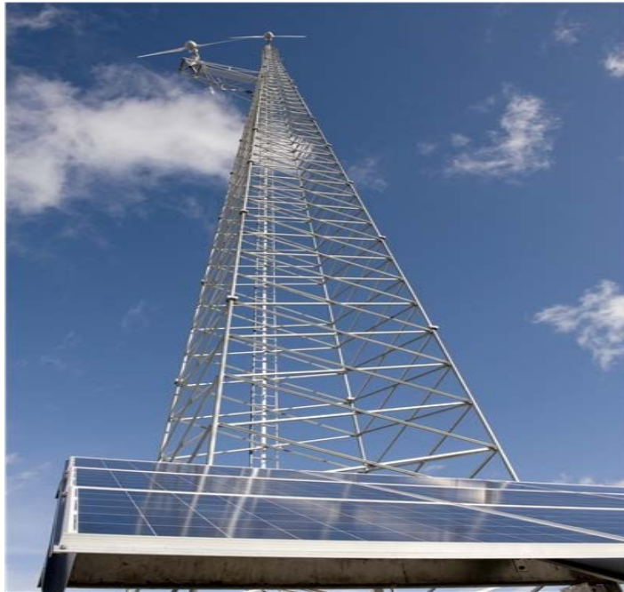
Εικόνα 12: Ανεμογεννήτρια και ηλιακά πάνελς στο σταθμό βάσης E-site[12]
