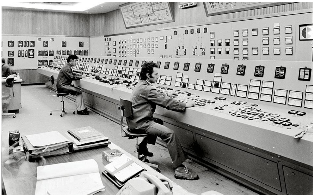
Κέντρο ελέγχου ατμοηλεκτρικού σταθμού Μεγαλόπολης
