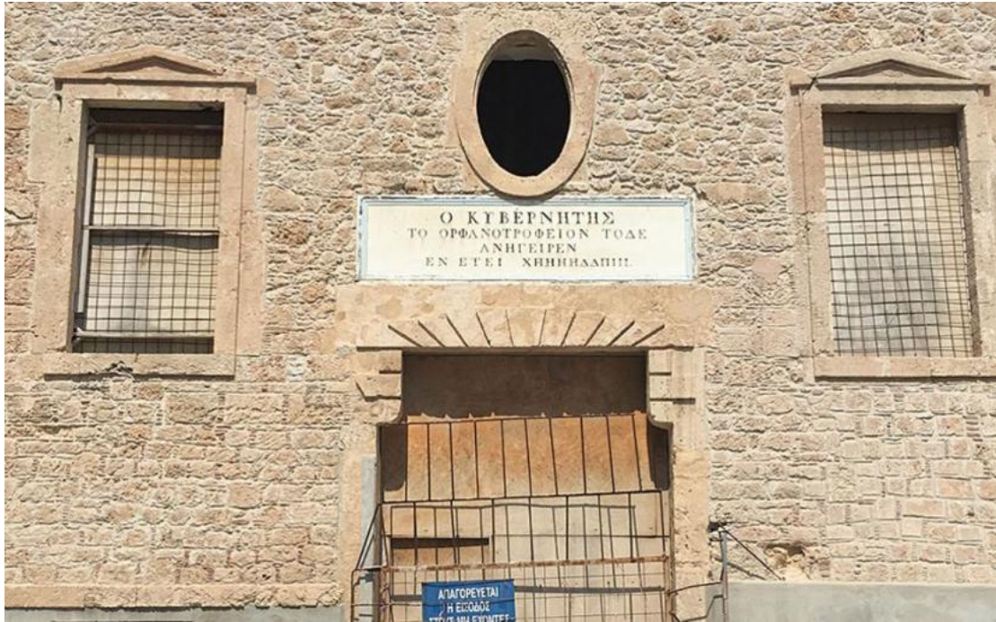
ΕΙΚΟΝΑ 3. Το Ορφανοτροφείο στην Αίγινα (Πηγή: Ορθοδοξία, Διεθνές Πρακτορείο Εκκλησιαστικών Ειδήσεων, διαθέσιμο στο: https://www.orthodoxianewsagency.gr/istoria-ethnika-themata/otan-o-kapodistriasis-idryse-orfanotrofeio-stin-aigina/ , ημερομηνία προσπέλασης 9.5.2021)
