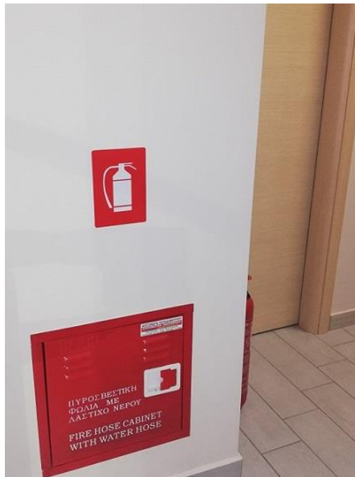
Εικόνα 2: Πυροσβεστήρας ο οποίος συνοδεύεται από την κατάλληλη σήμανση.
