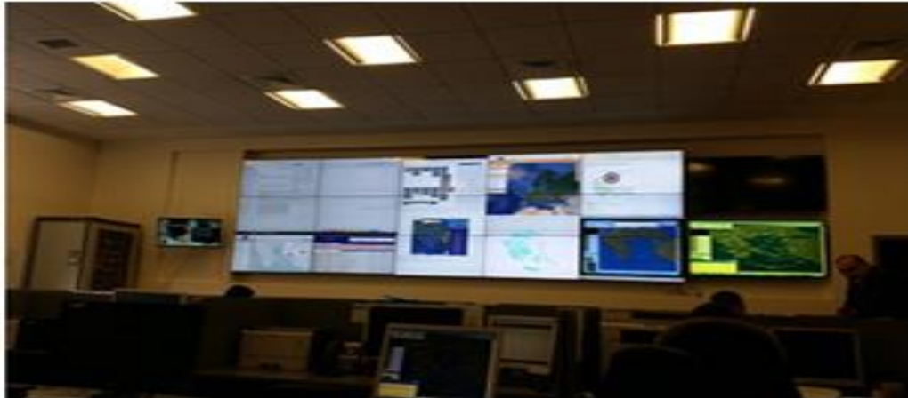
Εικόνα 6-6 Εσωτερικές Εγκαταστάσεις Ε.Σ.Κ.Ε.Δ.Ι.Κ
