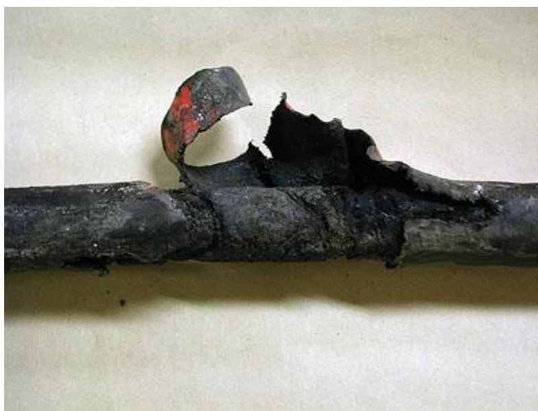
Εικόνα 2.9 Διάβρωση του μανδύα σε καλώδιο Μ.Τ (24)
