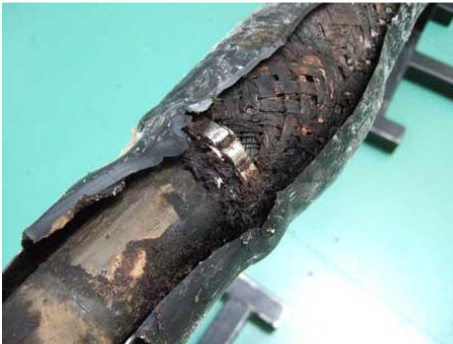
Εικόνα 2.12 Αστοχία σε μια εγκατεστημένη μάτιση δύο καλωδίων (30).
